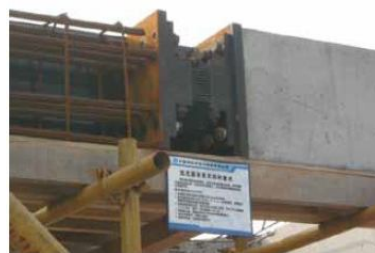
安装在连梁的阻尼器 图2 阻尼器
