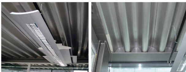
图 6 悬挂在压型板的照明和空调系统 图 7 压型板的角部细节
