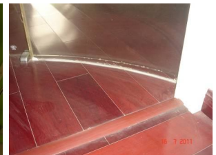
图 5 2006 年做的地板缝盖板粘有机胶的老化剥离
