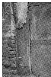
图6 1层④/④柱腐朽
